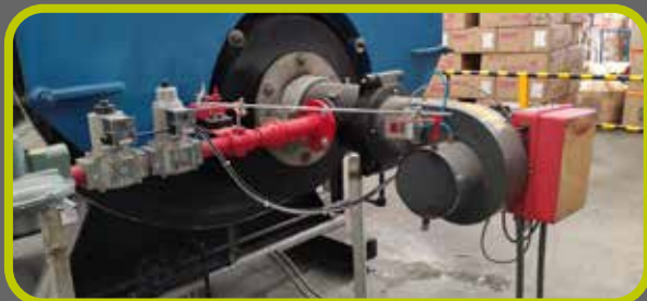
Sistemas de Calentamiento de Agua
