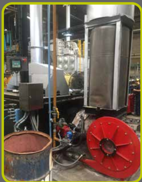
Pote de Calentamiento
