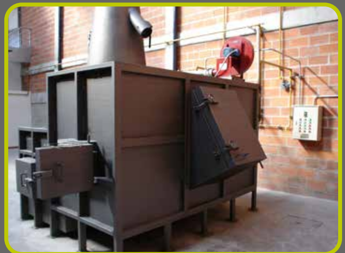
Incinerador de Residuos
