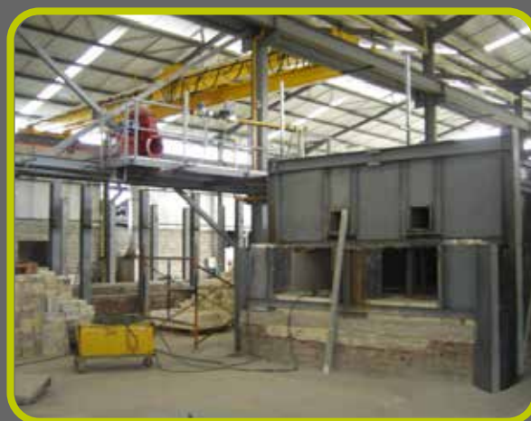
Aislamiento Térmico de Hornos
