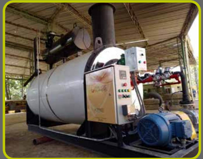
Calentamiento de Aceite Térmico para Asfalto
