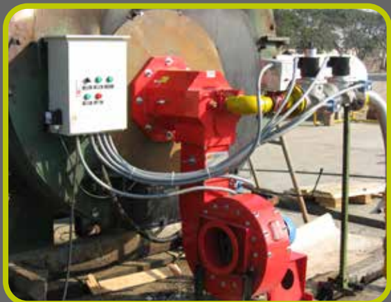
Calderas para Generación de Vapor
