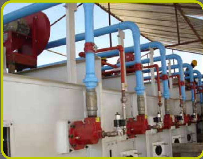
Hornos Tratamiento Térmico
