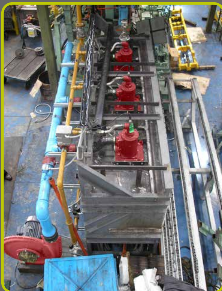
Hornos de Tratamiento Térmico
