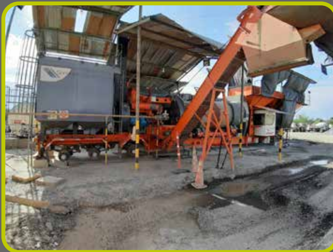
Plantas de Asfalto
