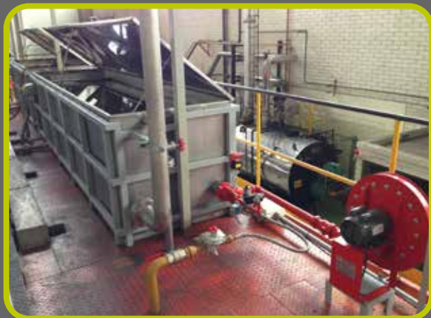
Tanques de Calentamiento de Fluido
